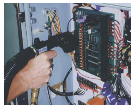
Aspiración de Polvos y Partículas Nocivas en Tableros Eléctricos
